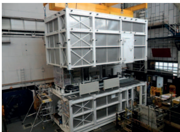
工場試験時の廃棄物容器の充填・梱包・搬出モジュール
